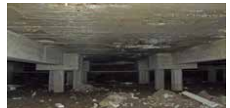
Ernstige betonschade van de bgg-vloer.
