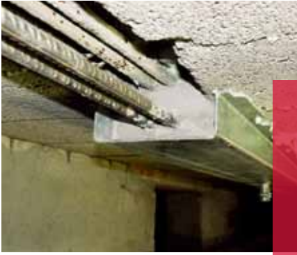
Schade aan betonnen T-liggers
