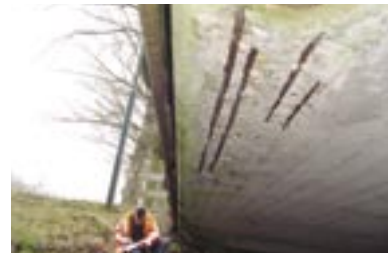
Inspectie ook aan de onderzijde!
